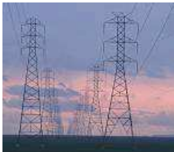
Lignes à haute tension
